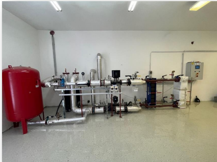
Fő hőközpont átadott állomása
